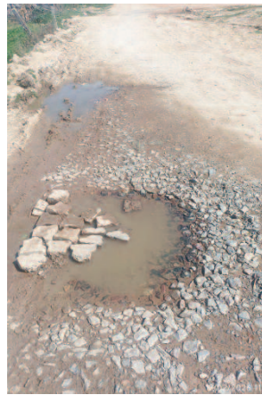
टैटीगांव-खैरमार्ग पर गांव जरारा से झंडा के बीच क्षतिग्रस्त सड़क का नजारा।
