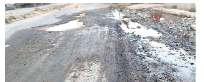
ट्रांसपोर्ट नगर में जर्जर सड़क का नजारा।
