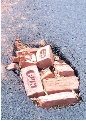
जिला जेल से आगे हाल ही में बनी सड़क में गड्ढा बना खतरा।
