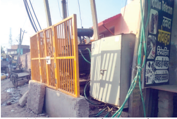
फरह कस्बा के मोहल्ला चटसाल में लगा 400 केवीए क्षमता का ट्रांसफार्मर।
