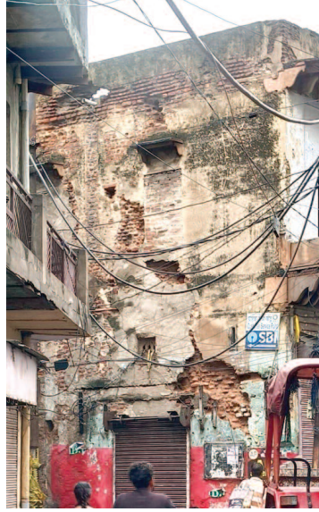
कुशक गली में मुख्य मार्ग पर जर्जर हालात में मकान।
