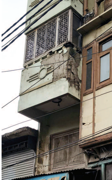
घीयामंडी में जर्जर मकान की बालकनी।
