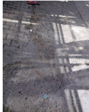
सड़क पर निकली गिट्टी।
