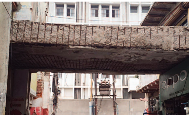
विकास बाजार के दो भवनों को जोड़ने को बनाया स्लेब, जो अब क्षतिग्रस्त है।
