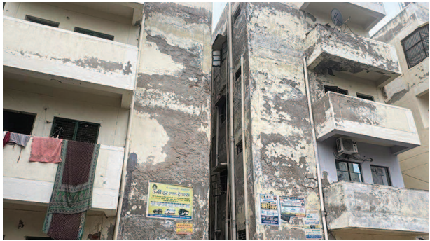
प्लास्टर खराब होने से जर्जर होते आवास।
