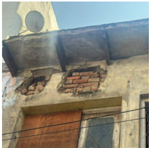
गली नंबर पांच में जर्जर छज्जा।
